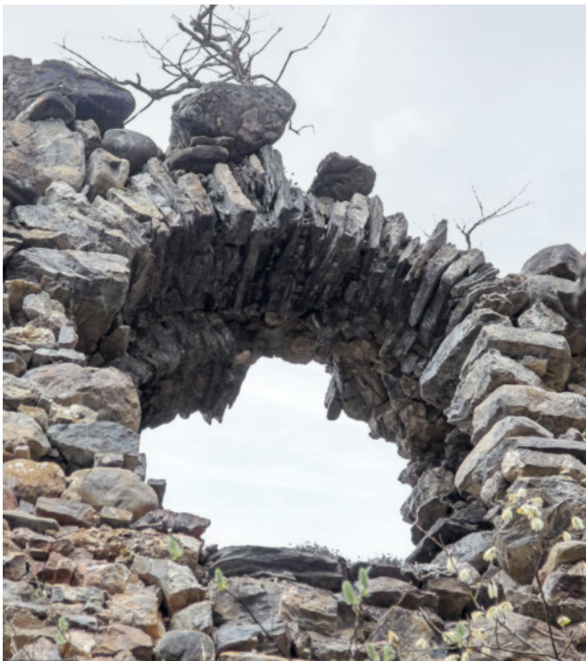
21: Ein Rundbogen-Fenster in der Nordwand des Anbaus, mit einem sich in Auflösung begriffenen Mauersturz. Vor August 2018.
