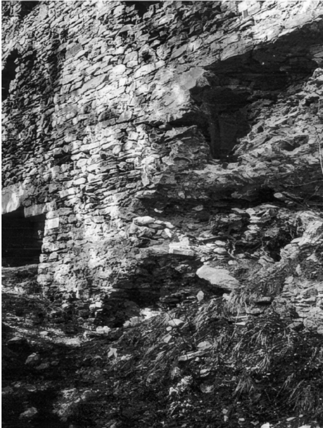
10: Grosses Loch in der Südwand des Turms, 1998.
