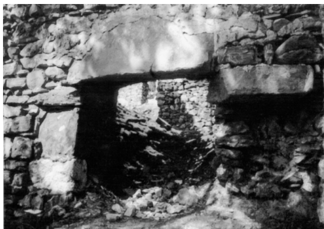
6: Fast vollständig zugeschütteter Haupteingang in der Südwand des Palas, 1998.
