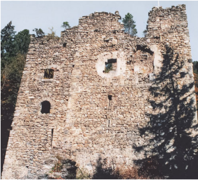
23: Diese Ansicht der Westfassaden vom Süd- und Nord-annex zeigt die desolaten Mauerkronen im Bestand und der nur noch als ausgebrochene und geschwächte Brücke erkennbare Fenstersturz am Palas. Wäre diese Brücke ausgebrochen und abgestürzt, wäre die ganze Süd-West-Ecke des Palas instabil geworden. Vor August 2014.
