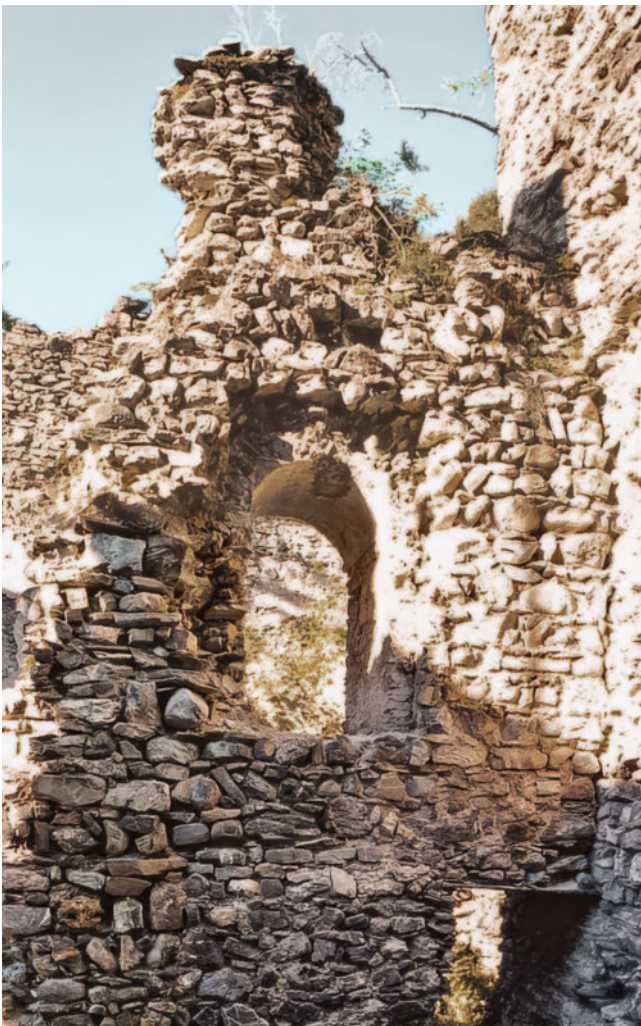
17: Ansicht eines Teilbereichs der Trennmauer zwischen dem Palas und dem Anbau. Der freistehende und sich nach unten verjüngende Mauerzahn stellte wie der fehlende Türsturz einen prioritär zu sanierenden Mauerbereich dar. Vor August 2018.
