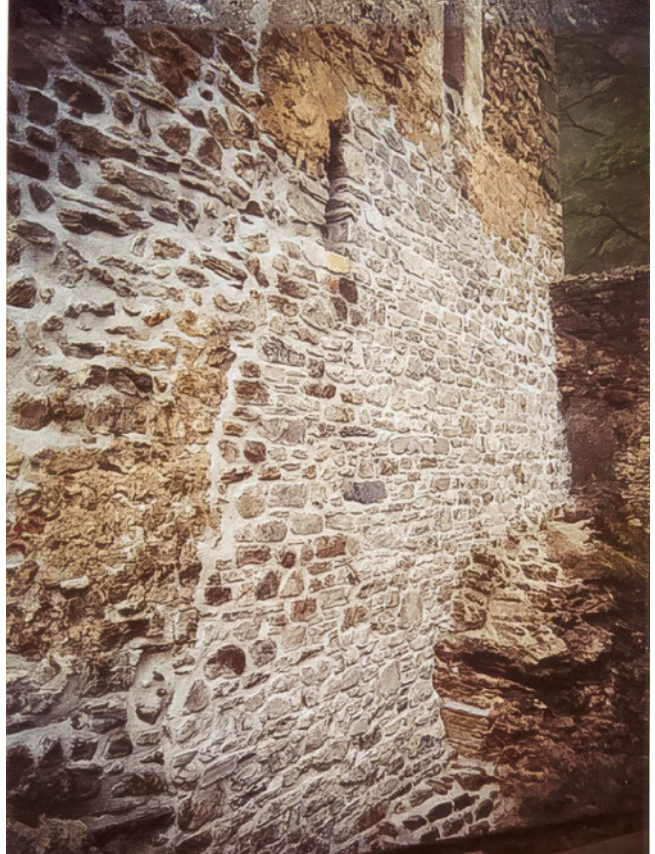
11: Südwand des Turmes nach der Sicherung des grossen Mauerausbruchs 2000/2001.
