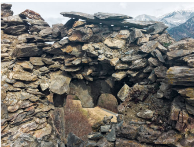
3: Chur, Haldenstein, Burg Haldenstein, Zustand Kronenbereich vor Sanierung.
