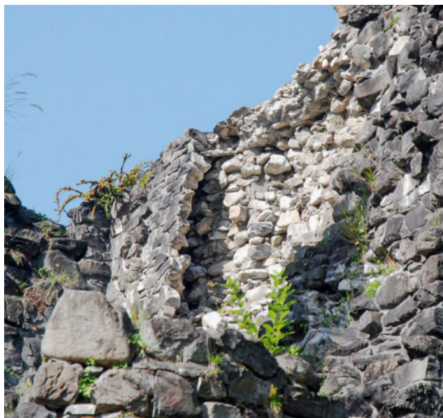
12: Attinghausen, Attinghausen UR, Turm. Der anlässlich der Sanierung in den Jahren 1897/98 neu aufgeführte Mauer-mantel hat sich grossflächig vom Kern gelöst. Ein grosser Teil davon ist bereits weggebrochen. Aufnahme 2011, von Nordosten.
