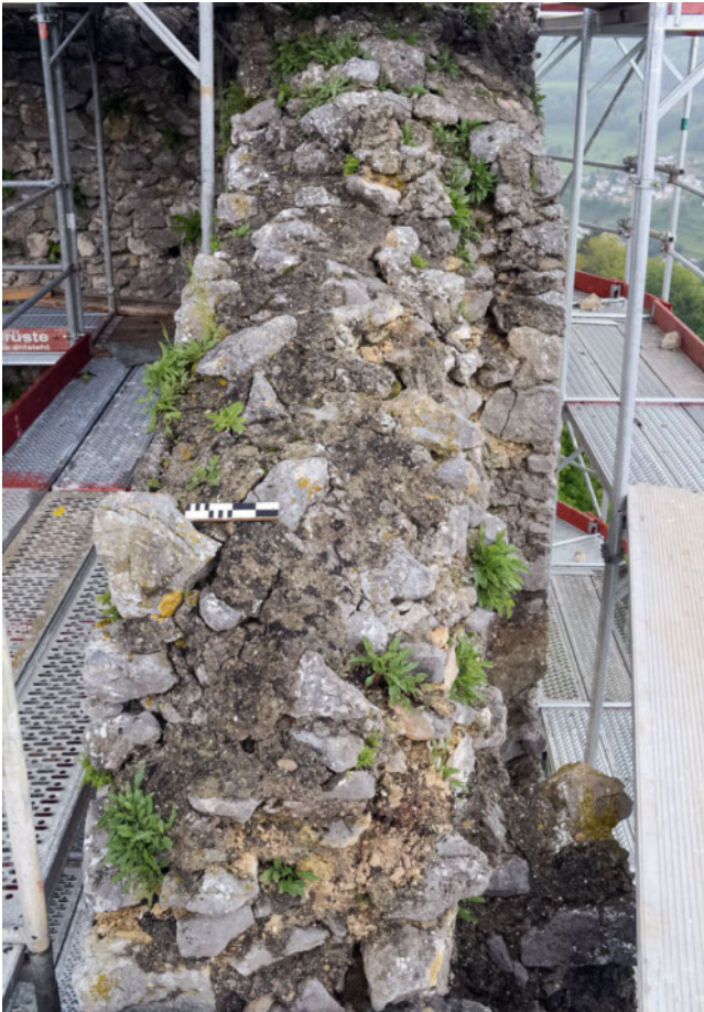
7: Pfeffingen, Pfeffingen BL. In den 1930er-Jahren mit hartem Zementmörtel abgedichtete Mauerkrone. Der Überzug ist gerissen und stellenweise abgeplatzt. Das darunter liegende, der Witterung frei ausgesetzte Kernmauerwerk ist stark aufgelöst.
