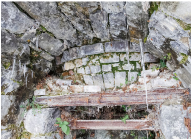
2: Sigiswil BE, Kalkbrennofen. Eiszapfen am Gewölbe weisen darauf hin, dass Wasser in flüssiger Form durch das Mauerwerk dringt. Diese Beobachtung ist nur im Winterhalbjahr möglich.
