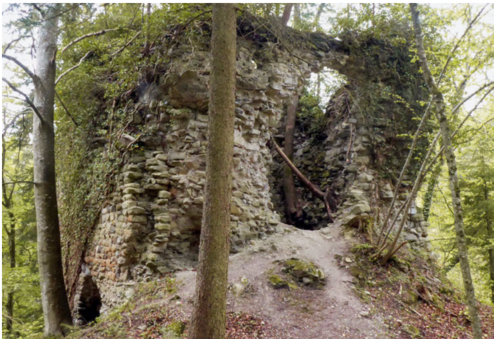
1: Arconciel, Gemeinde Bois-d'Amont, FR, Turm am südwestlichen Ende der Stadtwüstung. Das Bild zeigt verschiedene Arten schädlicher Einwirkung von Pflanzenbewuchs: dichtes Laubwerk (zur Zeit der Aufnahme im März 2020 noch nicht ausgetrieben), Efeu, Bäume und Sträucher. Aufnahme von Osten.
