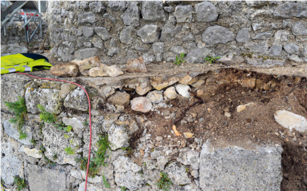
9: Pfeffingen, Pfeffingen BL, oberster Mauerabsatz im Wohnturm. Blick unter den bereits teilweise abgebrochenen Zementüberzug. Der unter dem Absatz liegende Mauermantel wurde in den 1930er-Jahren unter Verwendung vor Ort vorfabrizierter Betonsteine neu aufgemauert. Der magere, stark kalkhaltige und nicht frostfeste Füllmörtel des Mauerkerne ist zu Sand zerfallen und teilweise bereits vollständig ausgeschwemmt.
