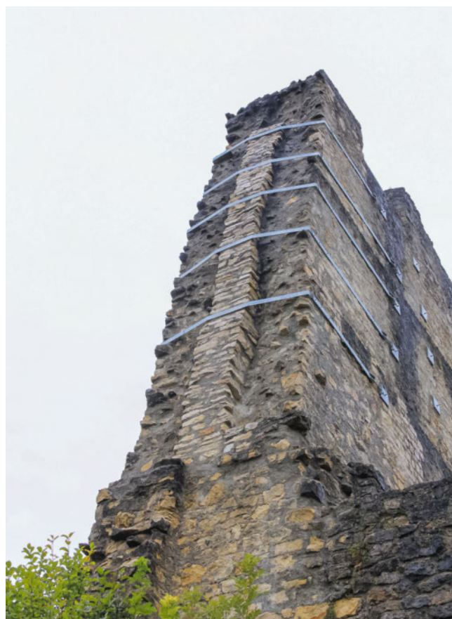
4: Ormalingen BL, Farnsburg. Statische Sicherungen durch Bänder und Anker an der grossen Schildmauer. Blick gegen NW, 2021.
