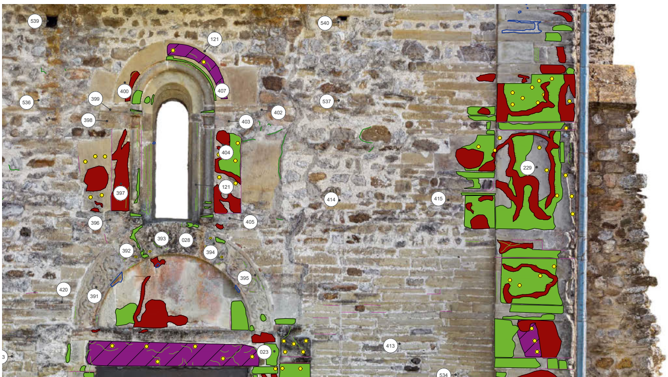
9: Rüeggisberg BE, Klosterruine. Vergrösserter Ausschnitt der Massnahmenkartierung von der Nordfassade des Querhauses. Wirz Restauratoren, 2019.
