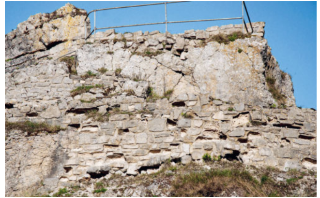
14: Frohburg, Trimbach SO, Mauerzug auf dem «Hohen Fels». Die klaffenden Lücken im dem 1977 mehrheitlich neu aufgebauten Mauerzug markieren die Stellen, an denen damals, wenn auch unbeabsichtigt, nicht frostfeste Steine eingebaut wurde. Die Schäden waren derart gross, dass man sich anlässlich der 2017 durchgeführten Sanierung dazu entschloss, die Mauer grösstenteils abzubauen und wieder neu aufzubauen. Aufnahme 2011, von Osten.
