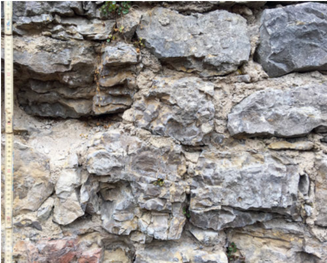
13: Farnsburg, Ormalingen BL. Ausschnitt aus einem in den 1950er-Jahren neu aus unterschiedlich frostfestem Muschelkalk aufgebauten Mauerwerk. Die im Bild sichtbaren Steine stammen aus demselben Steinbruch, aber aus unterschiedlichen Bankungen. Das Bild macht deutlich, wie Steine aus nicht frostbeständigen oder durch Sprengung abgebauten Bänken im Laufe der Zeit zersplitterten, solche aus einer guten Bank (im Bild rechts oben) die Zeit aber schadlos überstanden haben. Aufnahme 2020.
