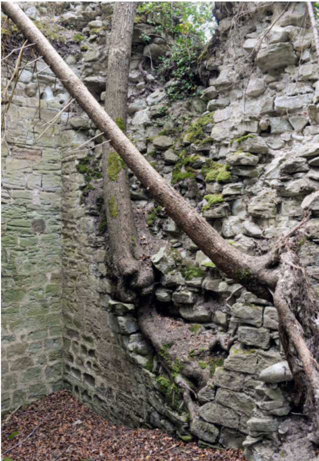
3: Arconciel, Gemeinde Bois-d'Amont, FR. Die Wurzeln des hinteren Baums spalten den Mauermantel vom Mauerkern ab. Aufnahme von Osten.
