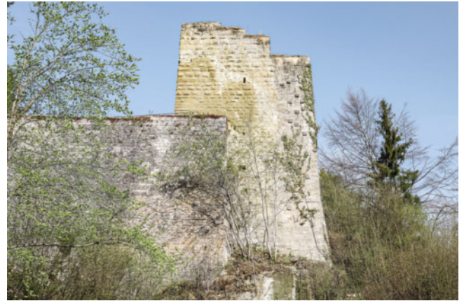
8b: Schwarzenburg BE Grasburg. Bergfried mit Salzausblühungen am 23.4.2023.
