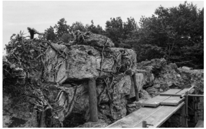
4: Kastelen, Alberswil LU, Ostmauer. Die Tuffsteinquader im Kronenbereich des äusseren Mauermantels waren vor der Sanierung des Turmes in den Jahren 1998 bis 2002 unter einem dichten Efeuteppich verborgen. Der Fugenmörtel war zu diesem Zeitpunkt bereits vollständig abgebaut und die Quader wurden nur noch durch die Efeuranken zusammengehalten. Aufnahme von Nordwesten.
