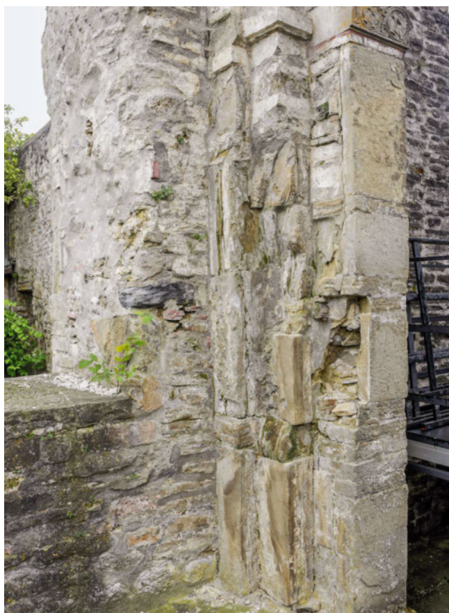
3: Rüggeberg BE, Klostersruine. Ausbruch am Mauerpfeiler der Klosterkirche.
