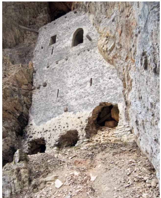
6: Rappenstein, Untervaz GR. Die höhlenartigen durch Frostabplatzungen entstandenen Ausbrüche sind für einen dauerhaft durchnässten Mauerfuss typische Schäden. Aufnahme von Nordwesten.
