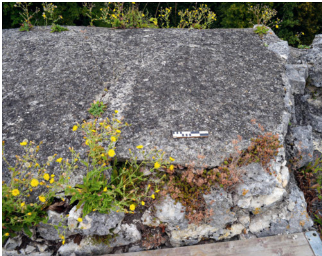
8: Pfeffingen, Pfeffingen BL. Harter Zementüberzug, in den 1930er-Jahren als Kronenabdeckung aufgebracht. Die an den Rändern hervorspriessenden Pflanzen machen deutlich, dass sich der Überzug vom darunter liegenden Mauerwerk abgelöst hat und sich darunter eine Humusschicht gebildet haben muss.
