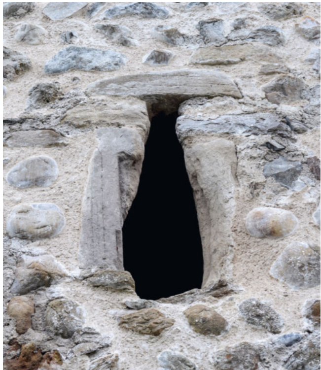
31: Häggenschwil SG, Ruine Alt Ramschwag. Turm. Schartenfenster 9.1 in der Mauer M9 des Erdgeschosses. Die beiden in der unteren Hälfte verbauten Sandsteinspolien und die Fensterbank sind von aussen her beschädigt. Möglicherweise wollte man sich so Zugang zum Turminnen verschaffen. Aufnahme 2024, von Südwesten.
