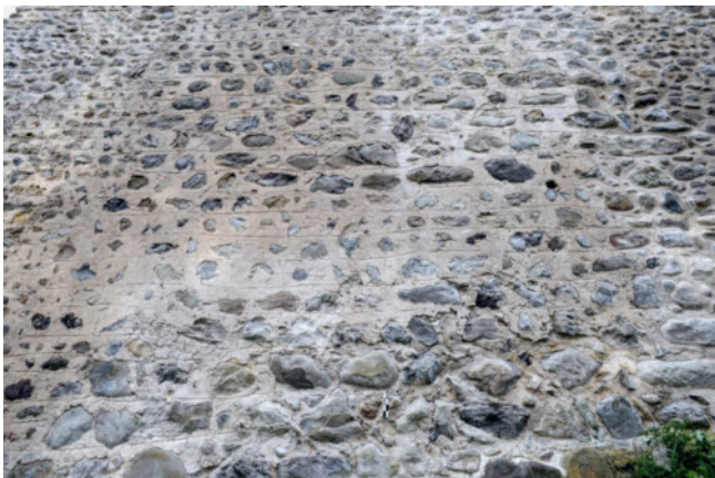
8: Häggenschwil SG, Ruine Alt Ramschwag. Schildmauer Aussenfassade. Mauerabschnitt SM1 mit qualitativem Rasa-Pietra-Putz mit Fugenstrich 1.17. Aufnahme 2024, von Südosten.
