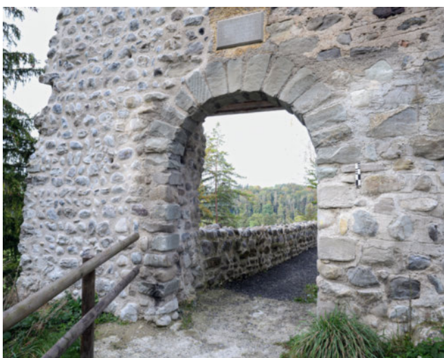
30: Häggenschwil SG, Ruine Alt Ramschwag. Tor, Aussenansicht. Der aus grob behauenen Sandsteinquadern bestehende Bogen wurde um 1930 rekonstruiert. Aufnahme 2024, von Südosten.
