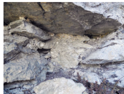
5: Herausgefallene Steine erlauben den Blick in das Innere der Südwestmauer: Einsatz von Kalkmörtel.
