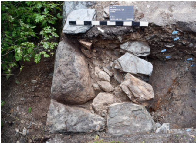
17: Hospental UR, Turm 2021. Aufsicht auf die Mauerkrone der Umfassungsmauer M5 (F3.1) mit zweischaligem Aufbau. Blickrichtung Nordost.
