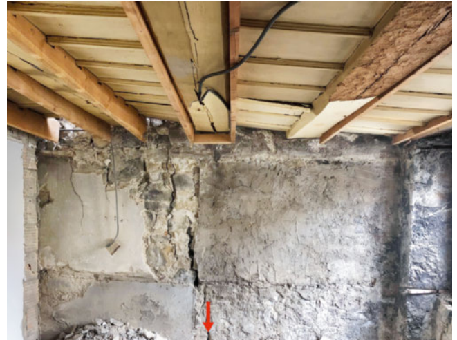
10: Der Anbau von 1690 hat sich im Bereich des Grabens gesenkt, was sich in der schrägen Decke zeigt. Die Risse in der Nordmauer (Pfeil) markieren den Verlauf der älteren Umfassungsmauer.
