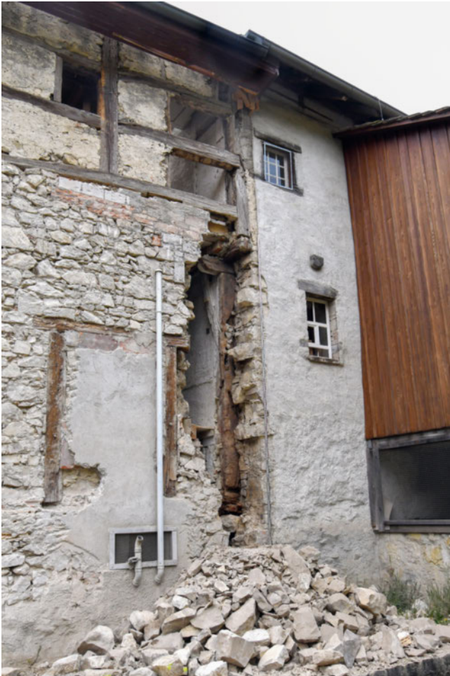
9: Während der Abbrucharbeiten ist an der Schnittstelle beider Hausteile die Versteinerung der Nordfassade gut sichtbar. Die Mauer ist dem Eckständer des Hausteils West (rechts) vorgesetzt und Wartesteine rechnen mit einer baldigen Fortsetzung der Maurerarbeiten im Hausteil Ost (links).
