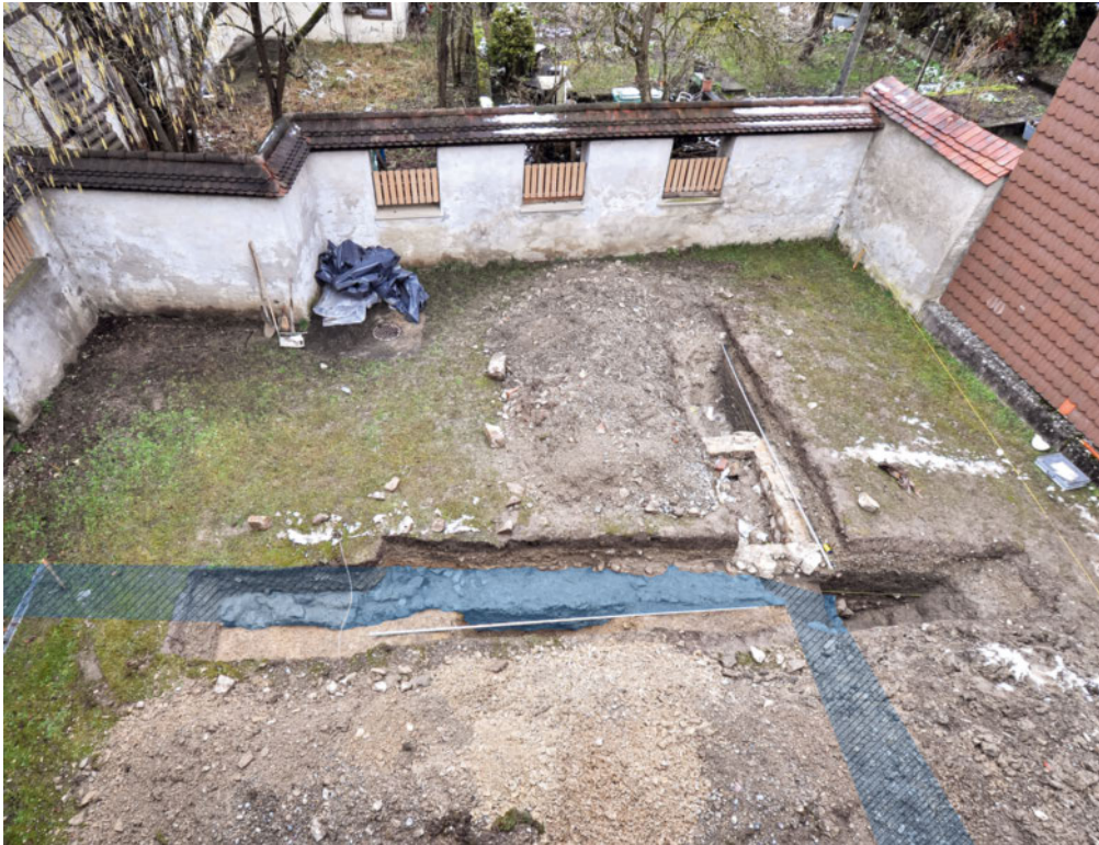
5: Die Sondierungen im Hinterhof mit der Umfassungsmauer (blau bzw. Verlauf der Mauerkrone blau schraffiert). Das daran anschliessende kleine Mauergeviert stammt von einer 1987 abgebrochenen Trotte.
