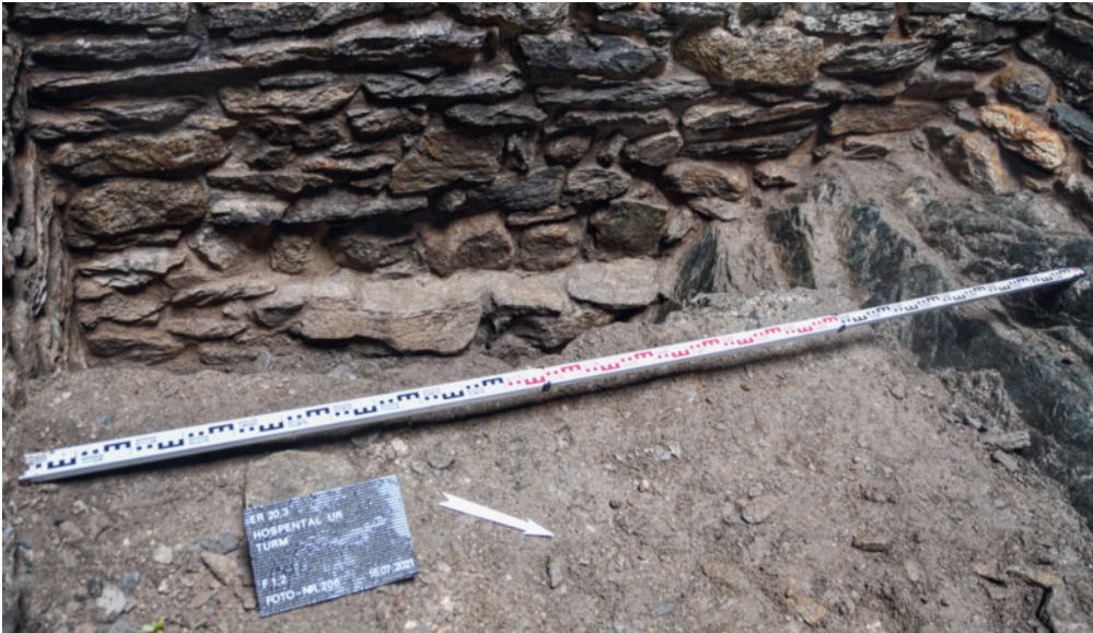
16: Hospental UR, Turm 2021. Übersicht des inneren Fundamentfusses von M4 (F1.2) mit steil abfallender Felskuppe (rechts), 1. Niveau, stufenartigen Absätze im Felsen, 2. Niveau mit Fundamentabsatz. Das 3. Niveau liegt unter der Aufschüttung verborgen. Blickrichtung West.
